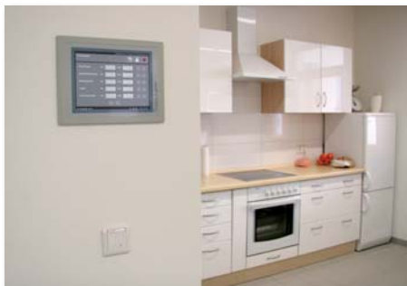
Mitarbeiterküche mit Masterpanel
